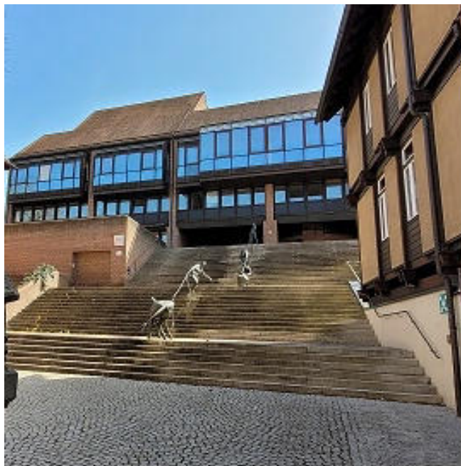
Die Treppe zur Gelbinger Gasse muss saniert werden. Grundstückseigentümer sind der Landkreis und die Stadtwerke Schwäbisch Hall.
