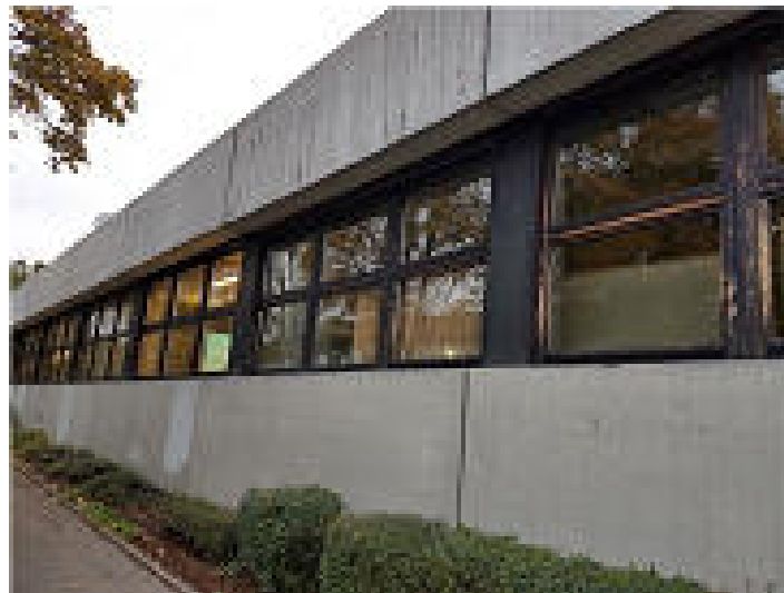
Ansicht der sanierungsbedürftigen Westfassade des Werkstattgebäudes G4 der Gewerblichen Schule Crailsheim.
